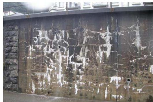
Abbildung 3: Charakteristisches AAR-Rissbild bei einer Stützmauer.
